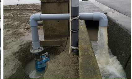
自動で排水ポンプが稼働
